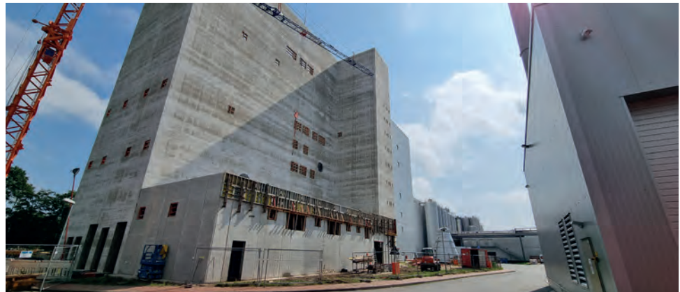
Afb. 3 De Lübbers sproeidroger met warmtepomp komt bij Molkerei Ammerland in een nieuw gebouw.
